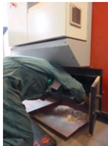
Maintenance de la chaufferie
