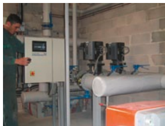
Maintenance de la chaufferie
