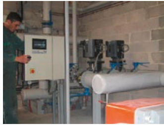
Maintenance de la chaufferie
