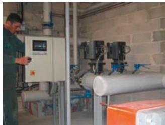
Maintenance de la chaufferie
